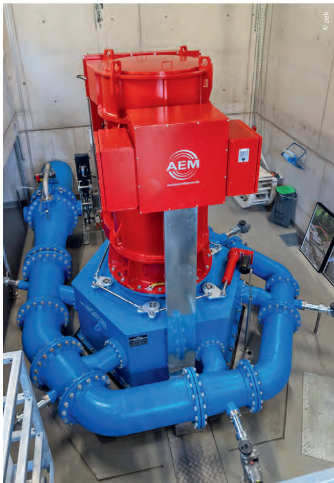
Das Herzstück des Kraftwerks Klaus bildet eine 6-düsige Pelton-Turbine, die bei vollem Wasserdargebot 600 kW Engpassleistung erzielt.
