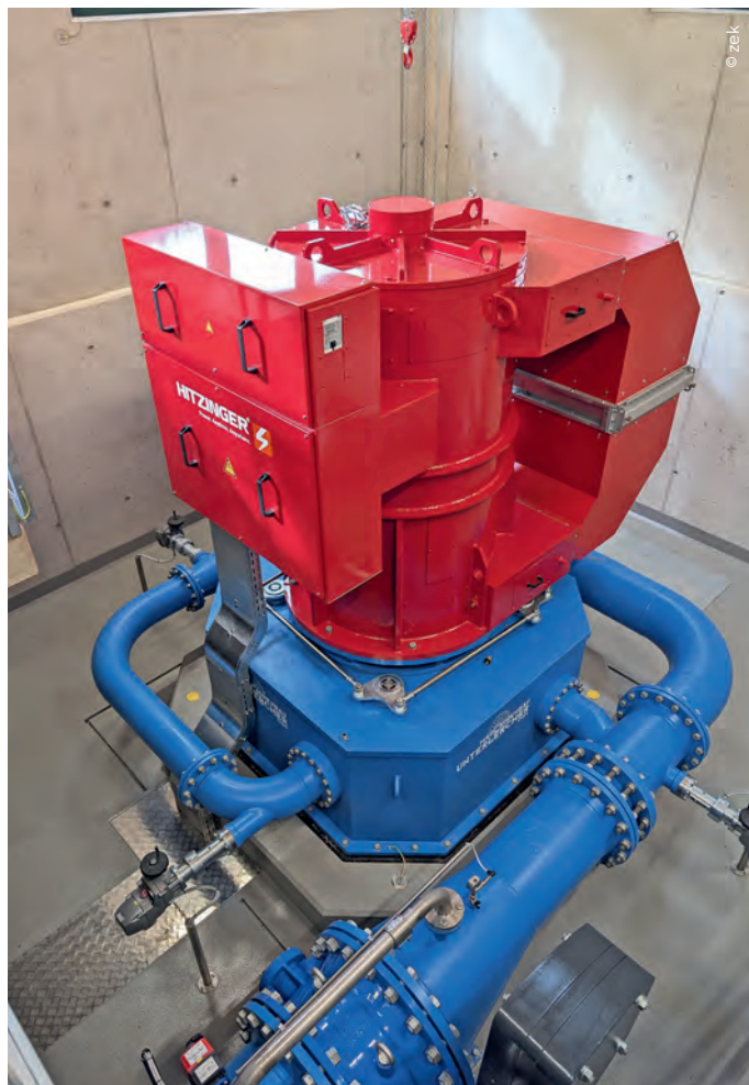
Das Kraftwerk Andexer nutzt zur Stromproduktion eine Pelton-Turbine in 4-düsiger Ausführung, die unter Volllast 530 kW Engpassleistung schafft.
